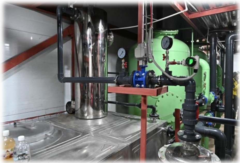
Введена станция обезжелезивания (с. Рожино, Хабаровский район)
